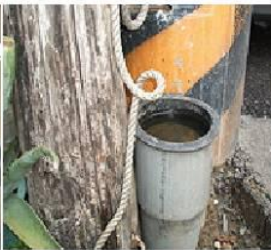
台電地下電纜引上管
