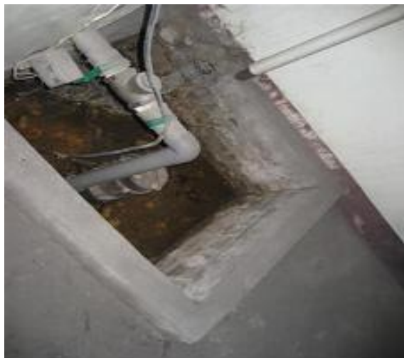
地下室儲水槽
