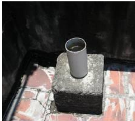
水泥樁上之水管
