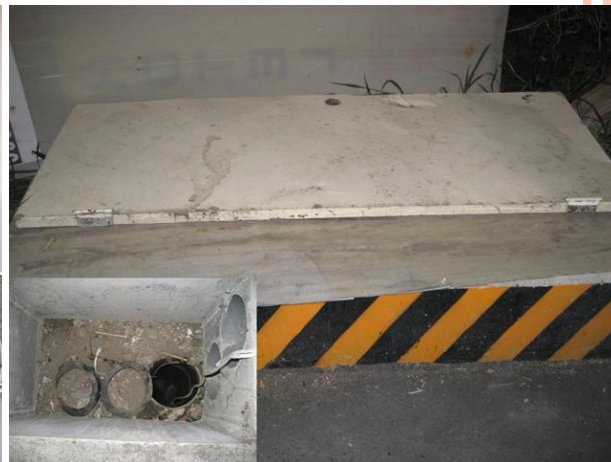
電信電纜管道
