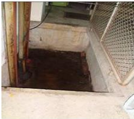
地下室之升降梯孔積水
