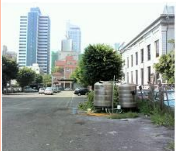
停車廠水塔無蓋
