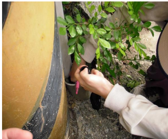
地下電纜引上管
